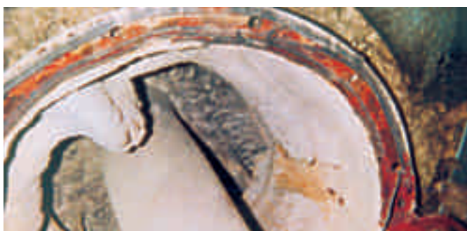
Наслоения, представляющие опасность для установки, образовавшиеся при транспортировке загрязненных пылью газов
