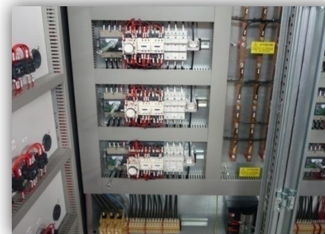
СИСТЕМЫ ПОЖАРНОГО ОПОВЕЩЕНИЯ И ОБНАРУЖЕНИЯ УТЕЧКИ ГАЗА
