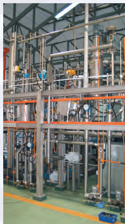
Полупромышленная установка для выпаривания метилового эфира
