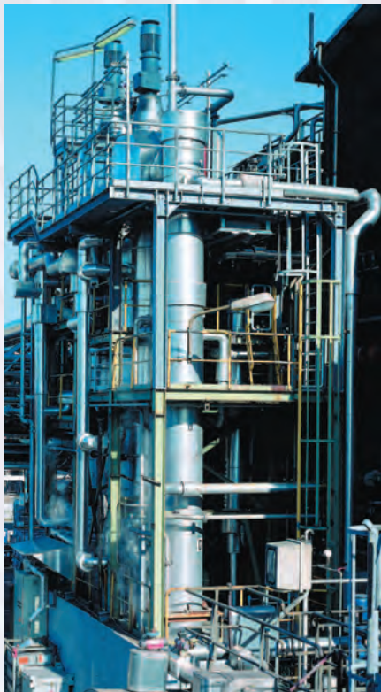
Двухступенчатая пленочная выпарная установка для концентрирования смолы
