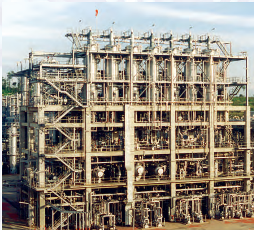
Самая большая в мире многоступенчатая вакуум-выпарная установка для производства мягких и твердых восков
